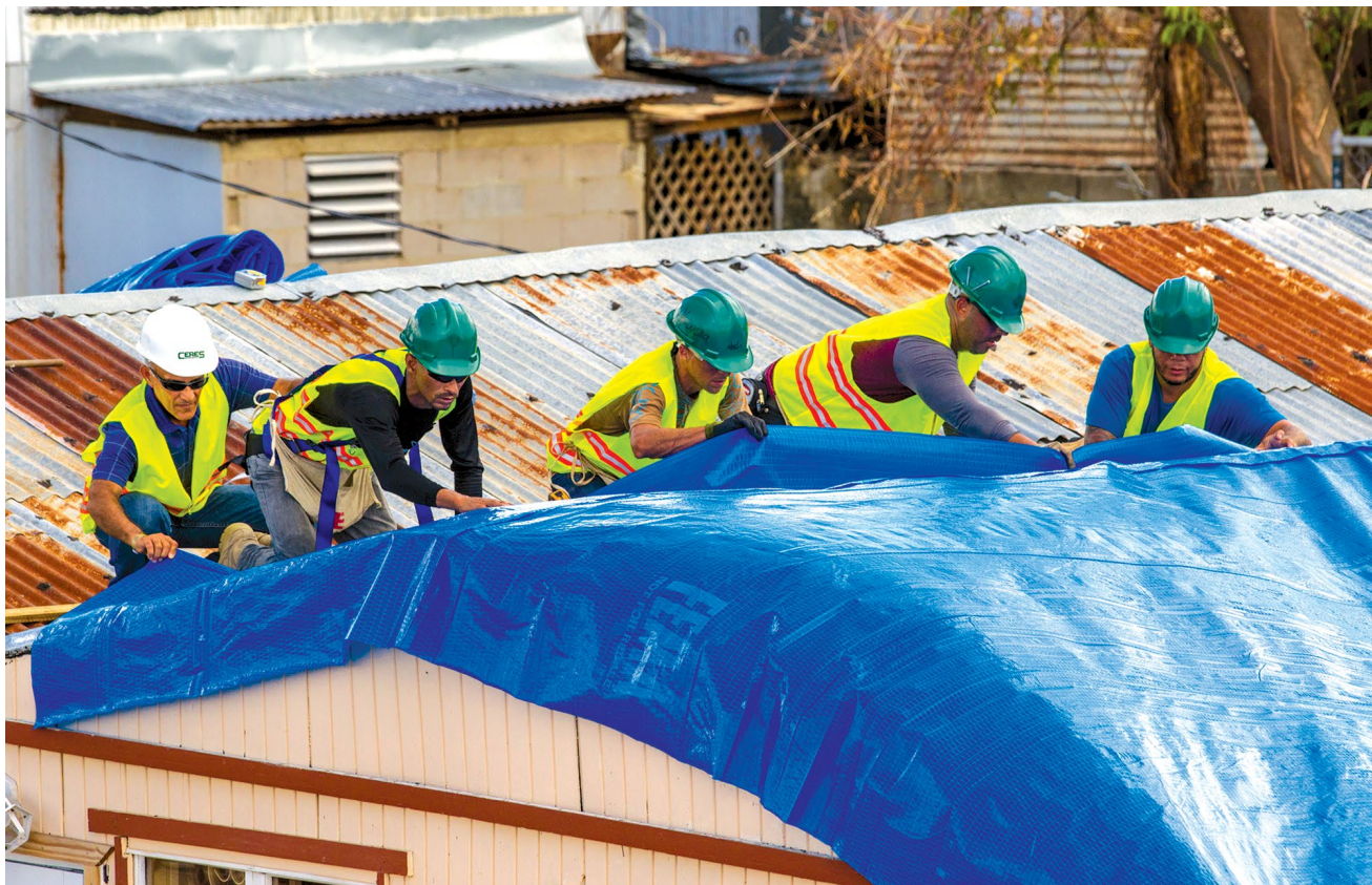
Contratados do Corpo de Engenheiros do Exército dos EUA instalam um “teto azul” temporário em Ponce, Porto Rico, 28 Out 17. Entre as várias missões de resposta a desastres, o Corpo apoia a Agência Federal de Gestão de Emergências (FEMA), fornecendo coberturas plásticas azuis para os tetos danificados por tempestades. (Sgt Avery Cunningham, Exército dos EUA)
