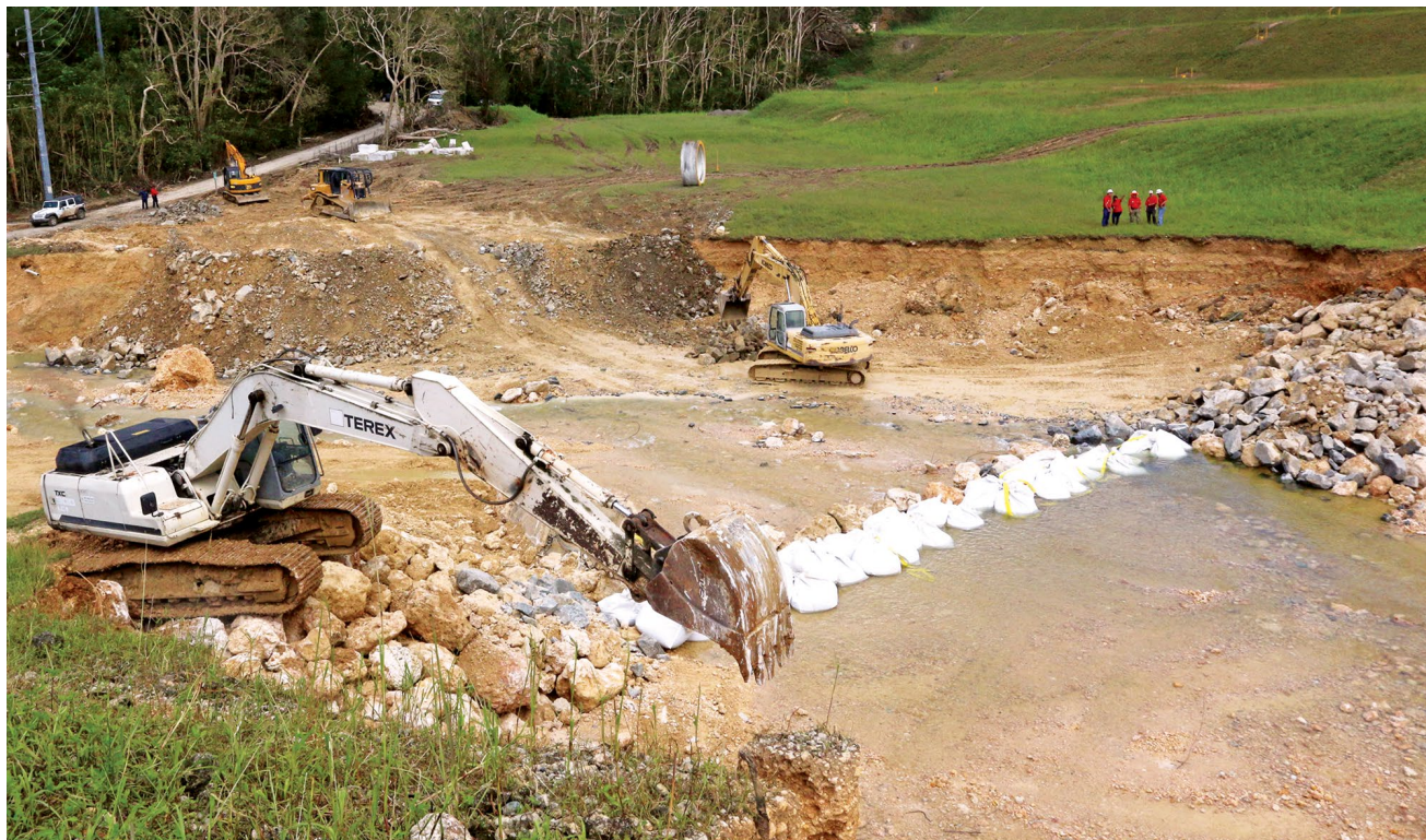
O Corpo de Engenheiros do Exército dos EUA reforça o vertedouro da represa Guajataca, construída há 89 anos, Isabela, Porto Rico, 09 Out 17. O Corpo de Engenheiros, a Guarda Nacional e contratados locais estabilizaram o vertedouro, a fim de garantir a segurança da população residente a jusante da barragem. (Cb Alleea Oliver, Exército dos EUA)
