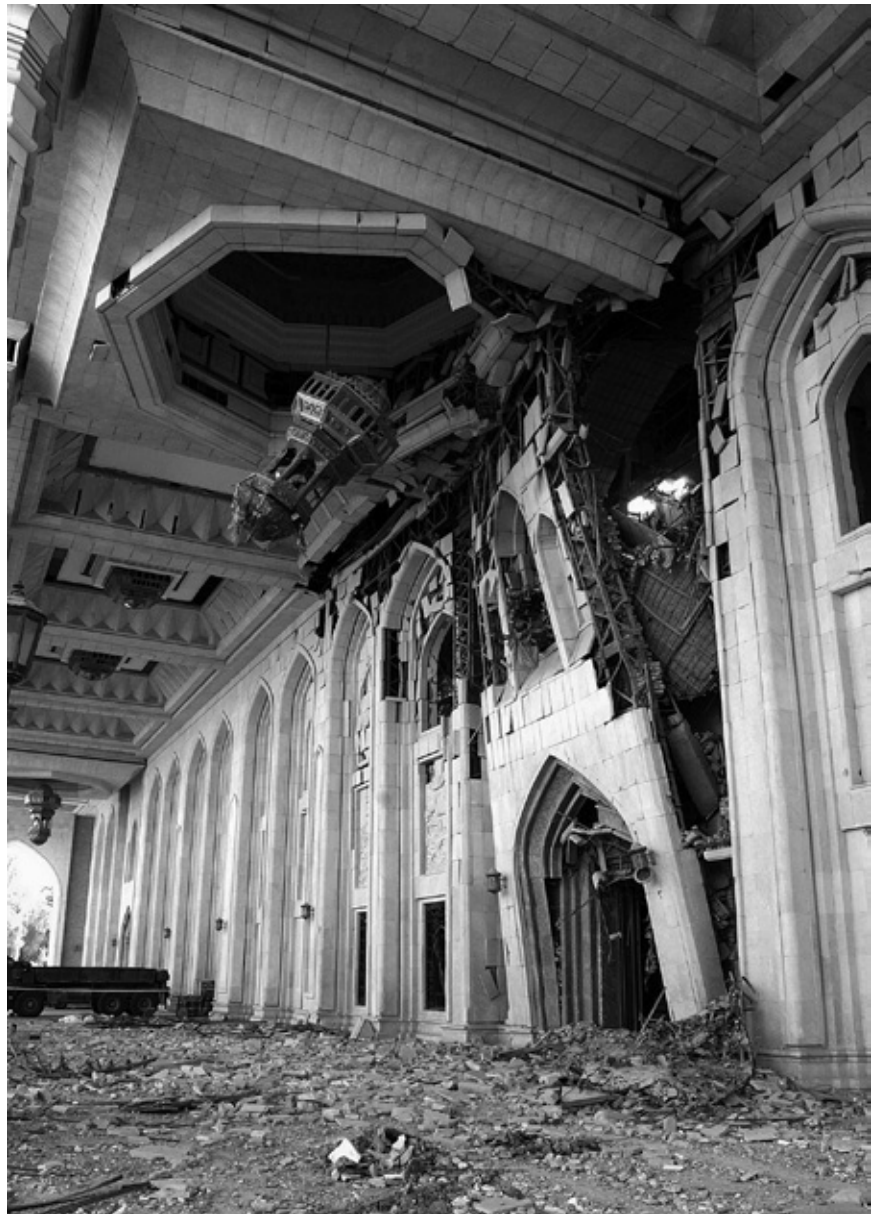
A fachada e o pórtico da sede danificada por bombas do Partido Ba'ath na Zona Internacional, Bagdá, Iraque, 23 de novembro de 2003.
