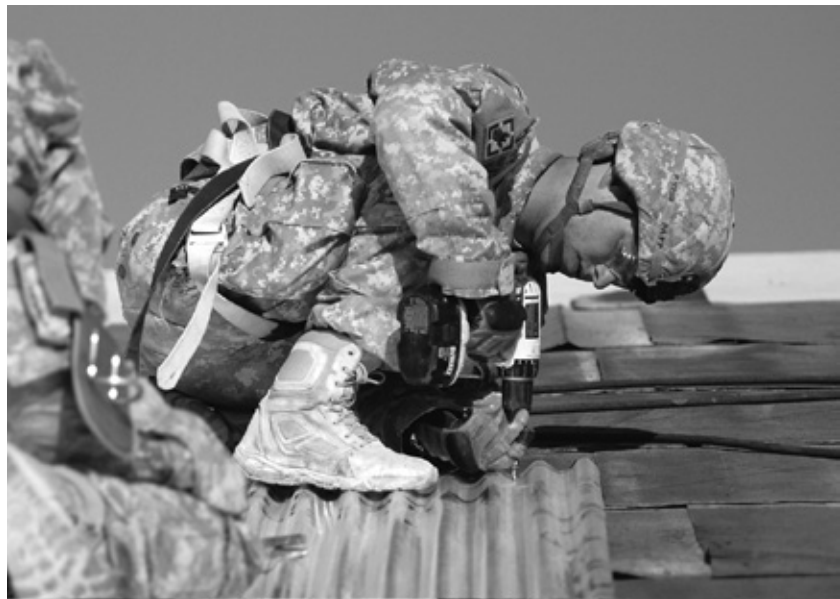
El soldado Michael Papp, Ejército de EUA, asignado al 19º Batallón de Ingeniería instala una lámina de zinc en un techo como parte de una obra de construcción en el Campo de Aterrizaje de Kandahar, Afganistán, 14 de septiembre de 2009.
