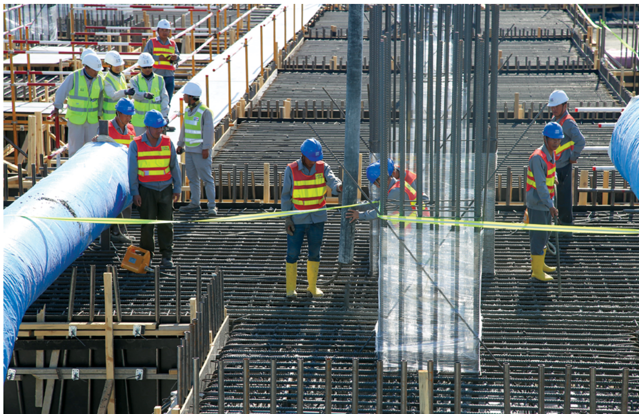
Empleados trabajan en la central térmica de Hunutlu, el mayor proyecto chino con inversión directa en Turquía, el 22 de septiembre de 2019 en la ciudad de Adana. El proyecto de US$1.700 millones encabezado por la Compañía de Energía Eléctrica de Shanghai es un proyecto emblemático que une la Iniciativa de la Franja y la Ruta propuesta por China con el Corredor Medio de Turquía. (Foto: Zheng Siyuan, Xinhua via Alamy Stock Photo)
